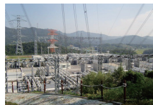
고삼면 쌍지리 신안성변전소 전경
